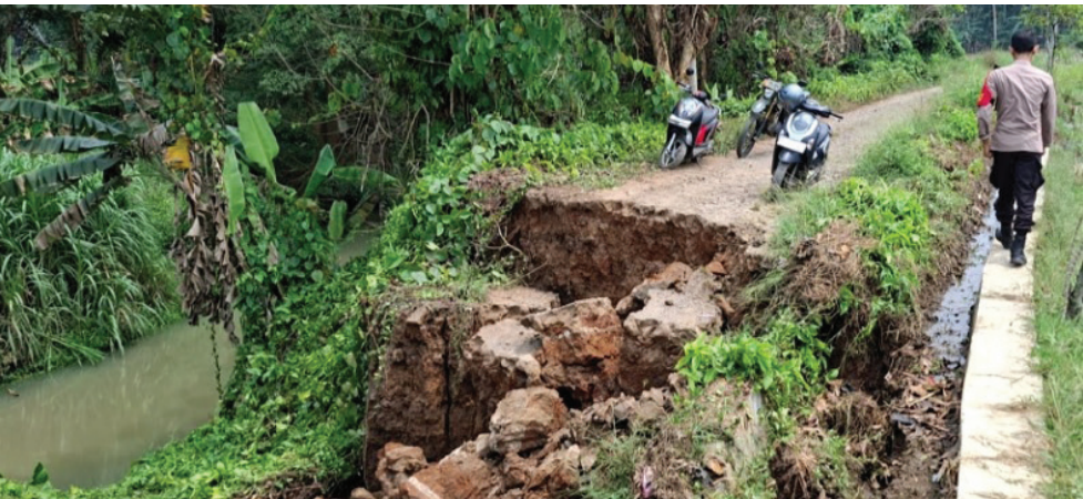
Tanah longsor memutus akses jalan yang menghubungkan Desa Bojong dan Desa Geredug, Kabupaten Pandeglang, Banten.
