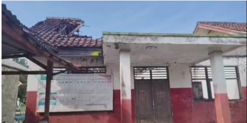
Kondisi sekolah yang rusak di Pandeglang.
